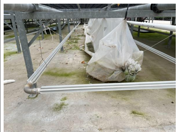
床架下冷風透明塑膠布風管、加溫熱水管，含散熱片。
