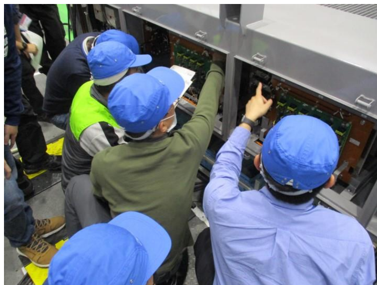
圖 9 輔助供電設備 SIV 實機確認
