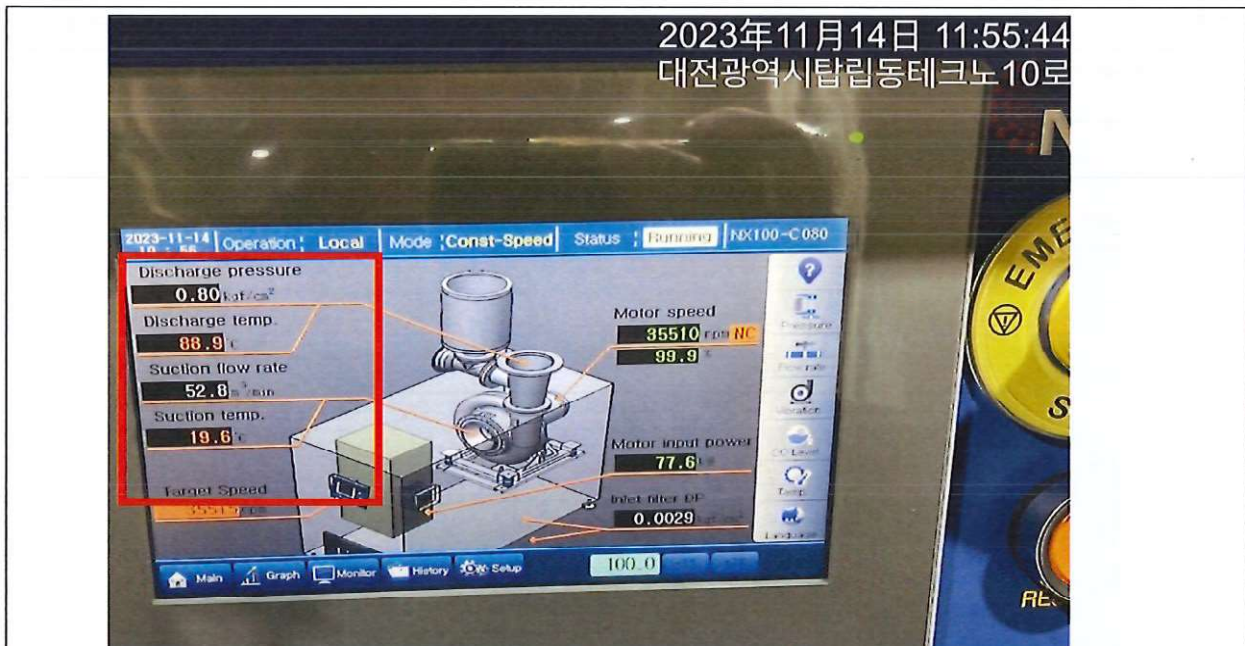
經查溫度、壓力顯示出入口均顯示於單元控制，(傳訊至中控室部份待系統測試完成後查驗) 符合規定
