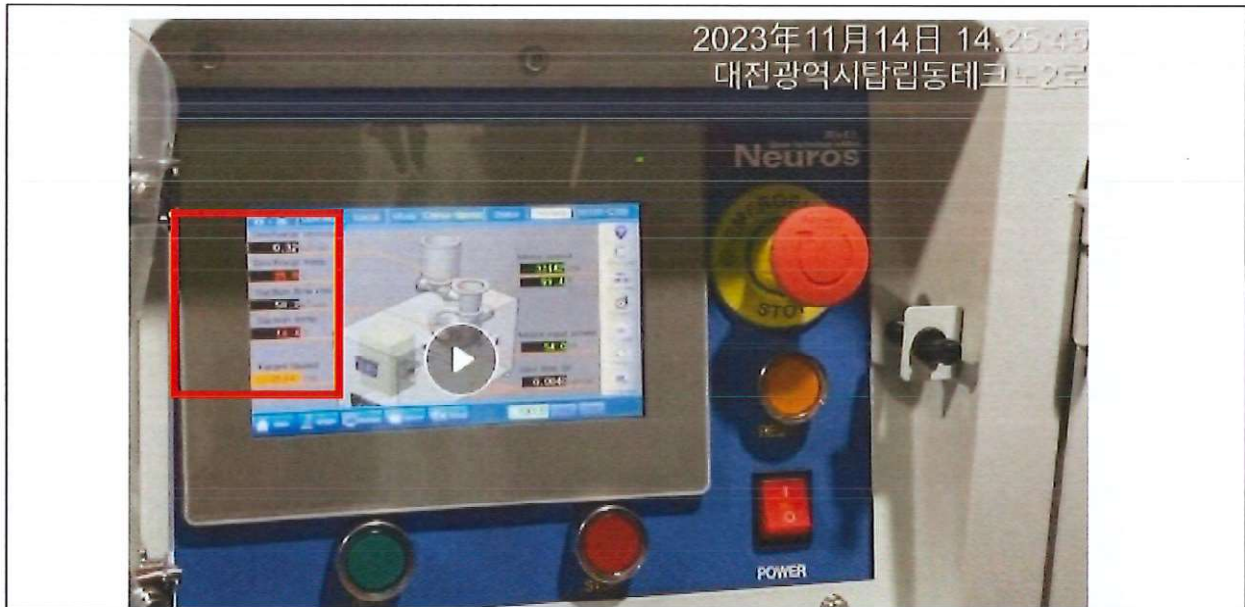
經查溫度、壓力顯示出入口均顯示於單元控制，(傳訊至中控室部份待系統測試完成後查驗) 符合規定
