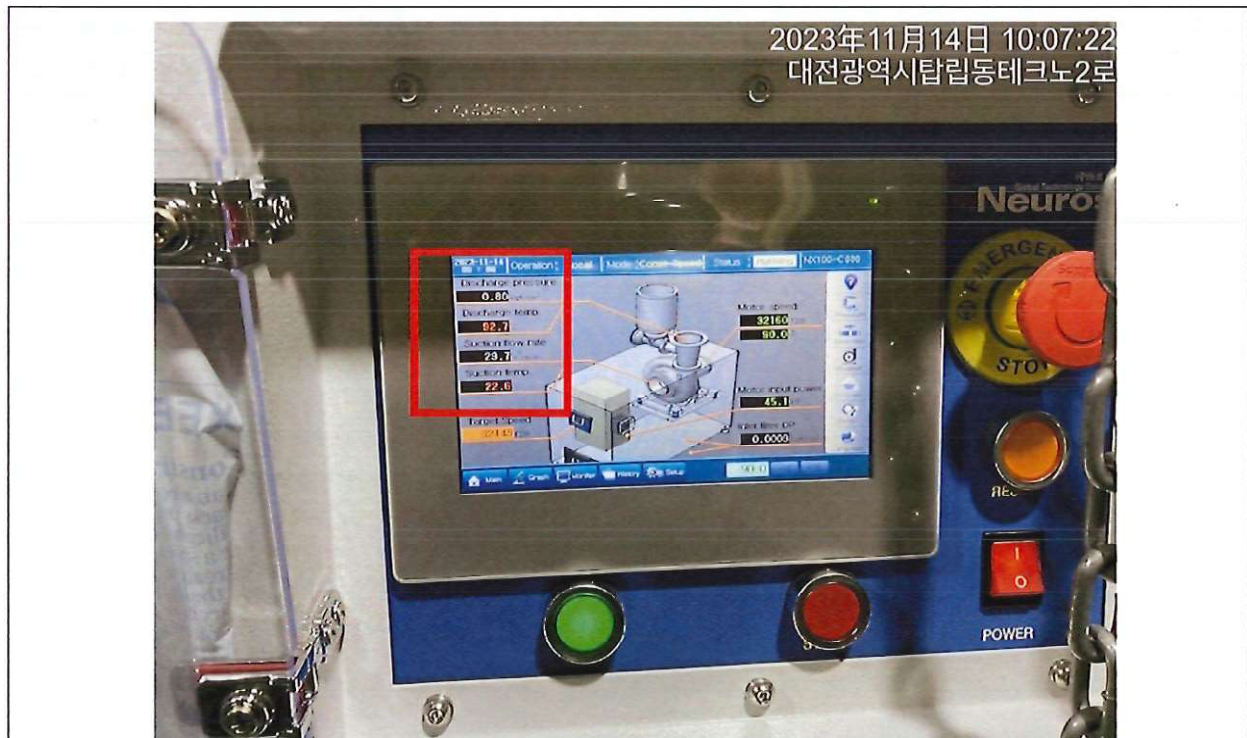
經查溫度、壓力顯示出入口均顯示於單元控制，(傳訊至中控室部份待系統測試完成後查驗) 符合規定
