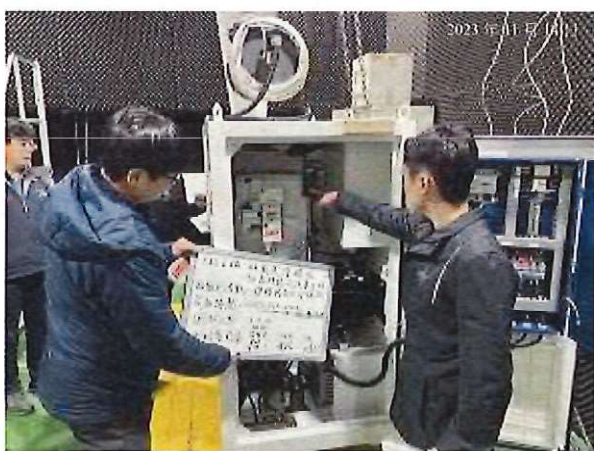
圖片說明:設備內部構造確認
