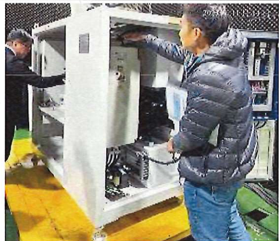
圖片說明:設備內部構造確認
