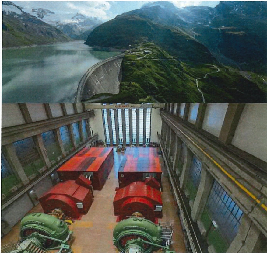
圖 39 Limberg I 抽蓄水力發電廠內照片
