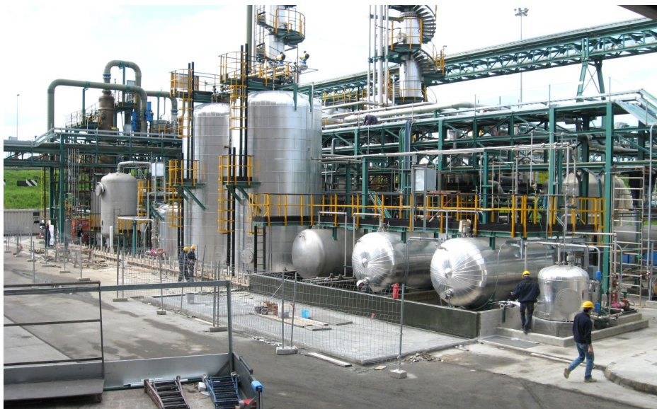
圖二十 化學溶液儲槽
