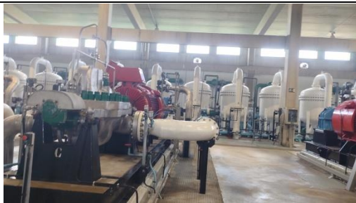
圖 21、San Pedro 海淡廠內設備
