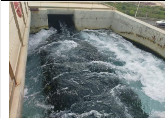
圖 9、Torrevieja 海淡廠海水進水池
