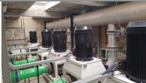
圖 19、San Pedro 海淡廠加壓站
