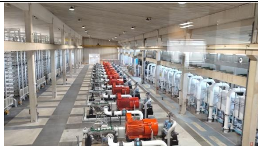
圖 20、San Pedro 海淡廠內設備
