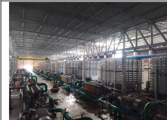
圖 13、Torrevieja 海淡廠內部設置
