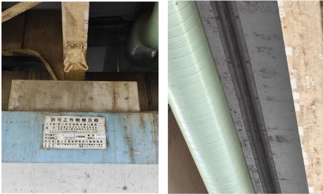
多摩川橋下掛有橋梁相關許可資料牌面，並於南北向橋面板間隙 採用彈性材料連結，避免滲水
