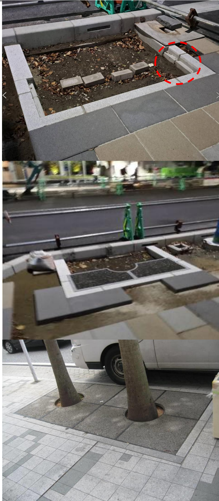
人行道辦理植栽與鋪面施工，採用較穩固之阻隔設施，非臺灣常見採用三角錐，樹穴蓋板有凹槽設計，不會壓實植穴土壤也能提供行人步行空間
