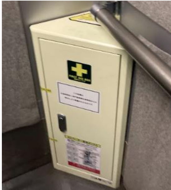
❖ 人與防災未來中心-電梯內急救設施
