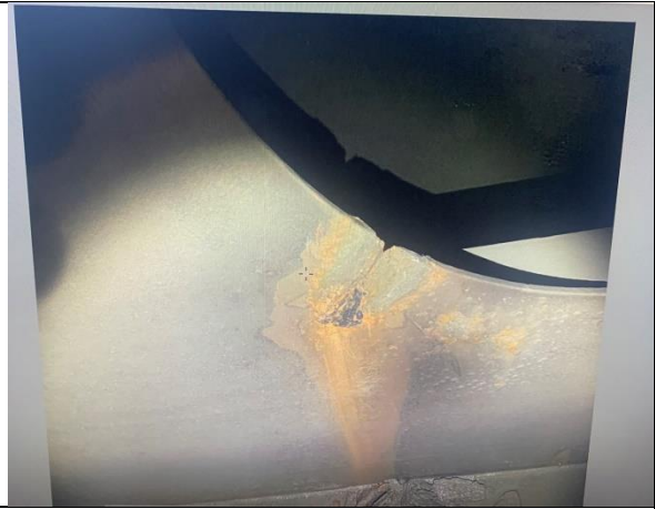
水艙 Web Frame 裂口
