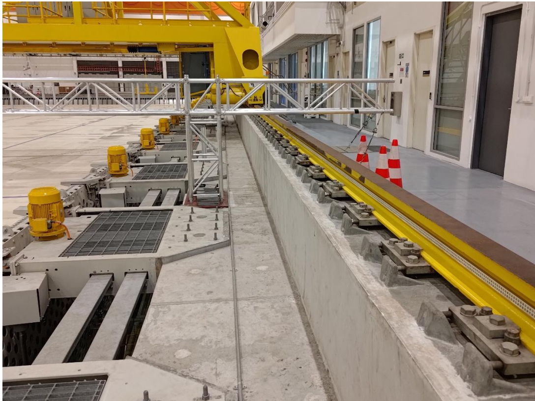
圖 8 TCOMS 深海試驗水槽設備：吸波側與軌道施裝工法
