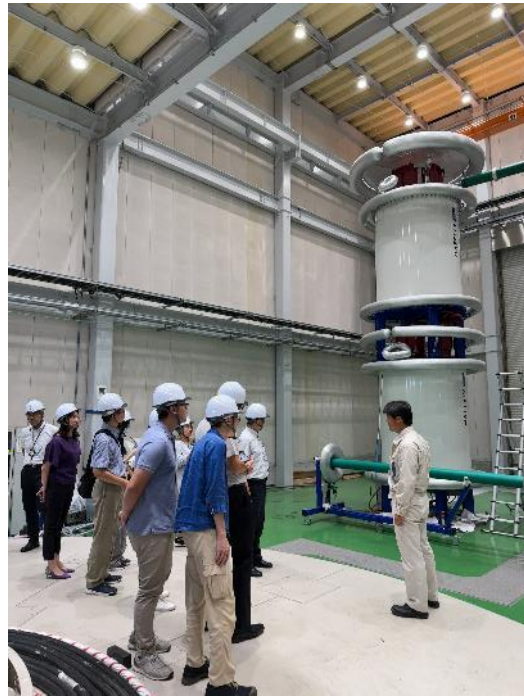
圖 36 500KV AC 變壓器
