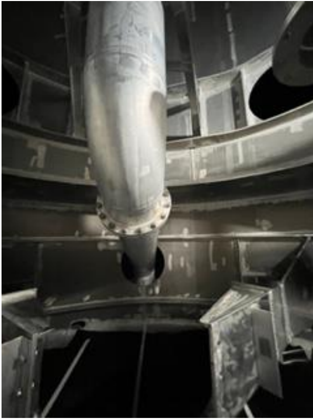
Discharging Line 進料主管
