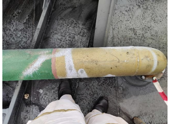
管路油漆局部破壞
