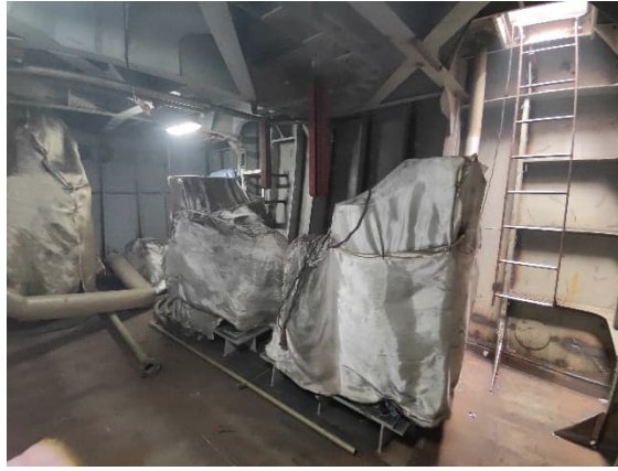
IGG BLOWER安裝位置
