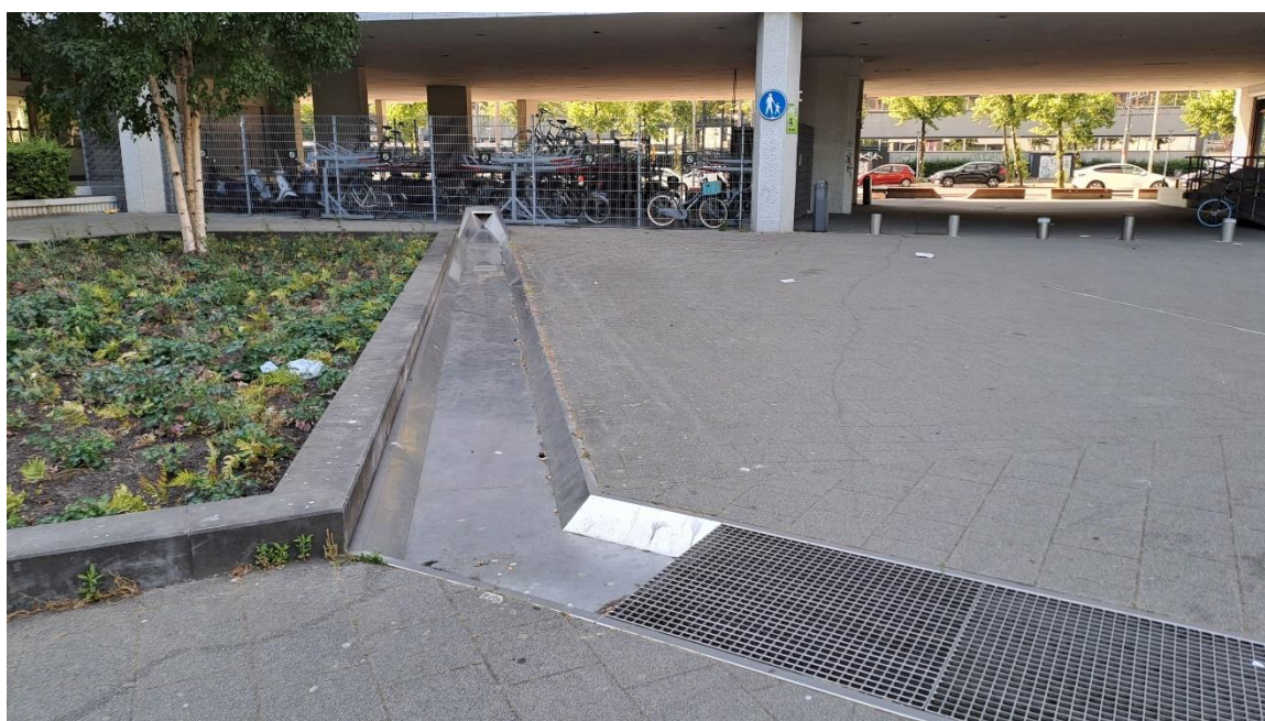
照片 15 屋頂雨水蒐集系統經由不銹鋼明溝導入廣場貯留
