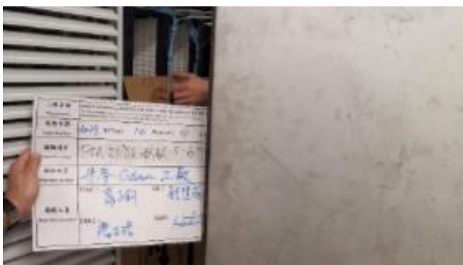
圖 5-38 拆下過濾器外蓋，阻塞 90%的過濾器，並驗證堵塞開關的功能是否正常。
