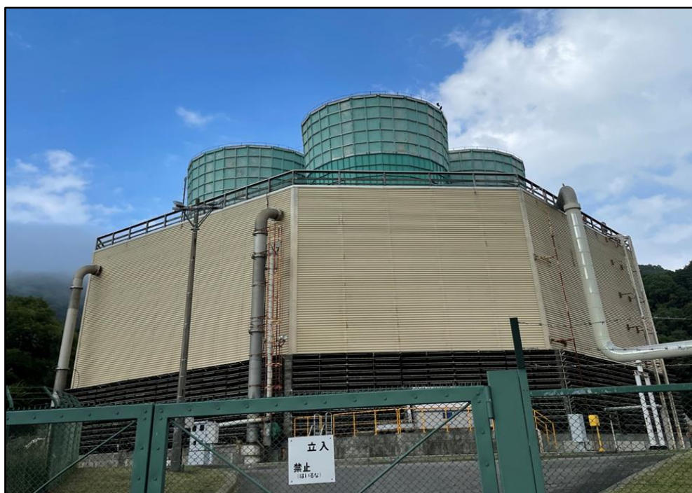
圖 23 森地熱発電所冷卻塔
