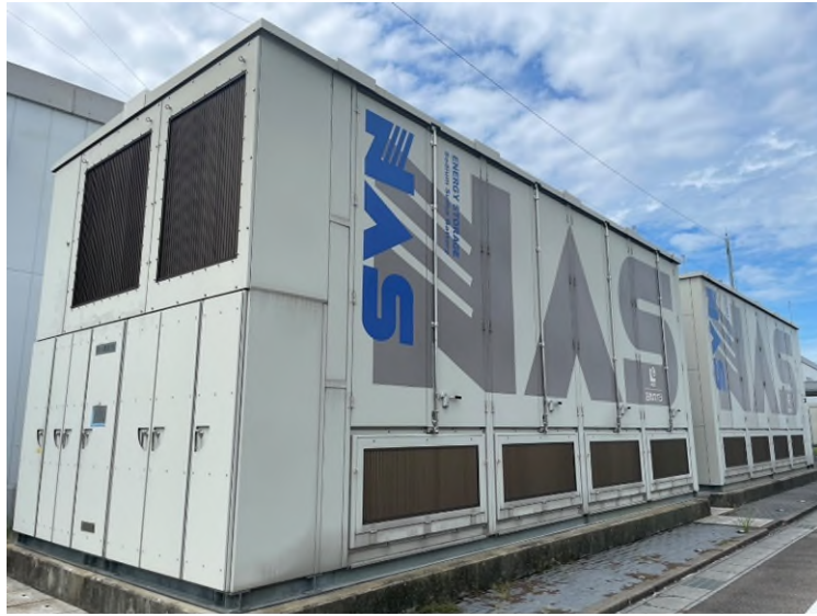
圖 36 機櫃型儲能設備排風口
