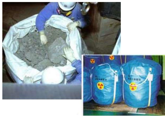
圖 17 太空包盛裝有混凝土等廢棄物並標示輻射標誌
