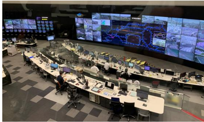
圖3-4-1 一宮道路管制中心
