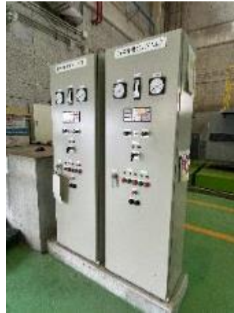
雨水電動泵浦控制盤
