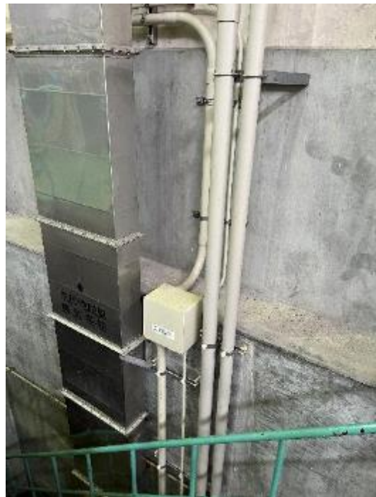
沉沙池除臭排氣系統
