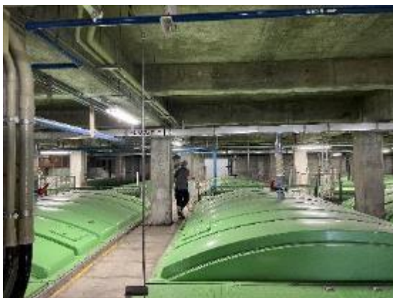
初沉池及除臭排氣系統
