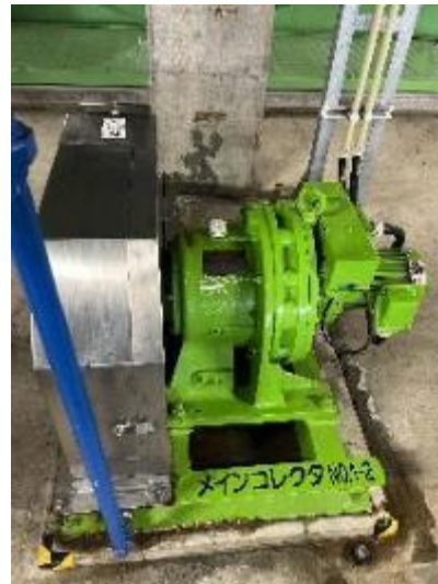
刮泥機驅動裝置
