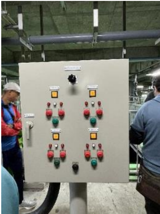
終沉池排浮渣間隙控制盤
