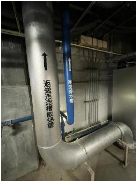
返送污泥槽散氣管
