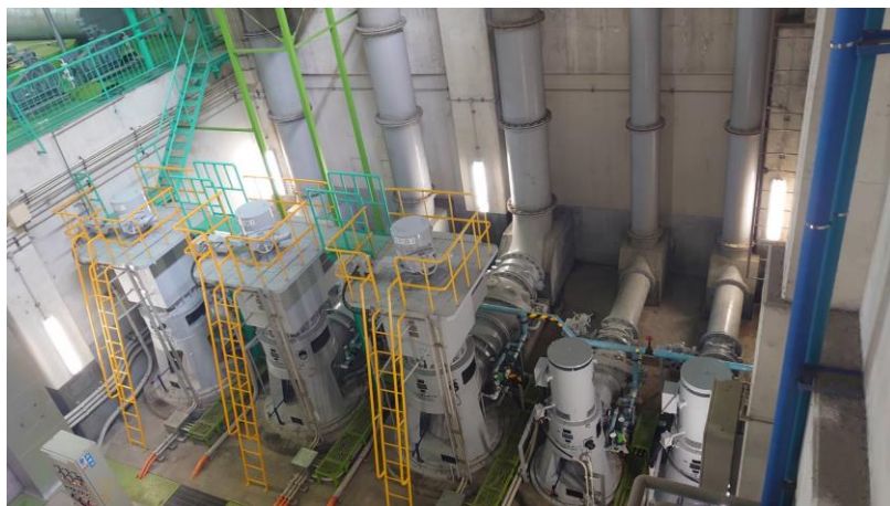
污水進流抽水機
