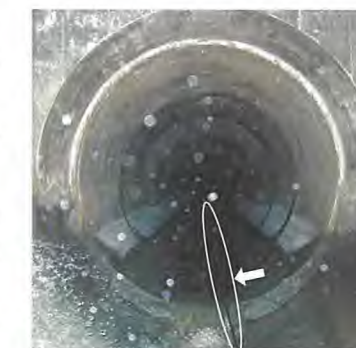
下水道管内の光ファイバー(ケーブル)
