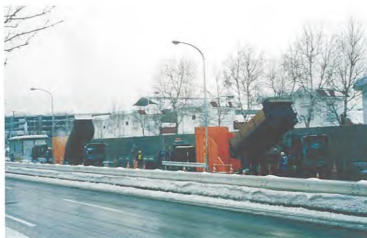
八軒下水道管投雪施設
