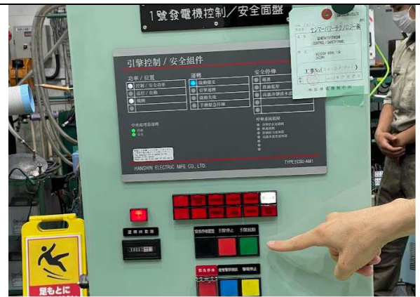
圖 15.一號發電機控制盤
