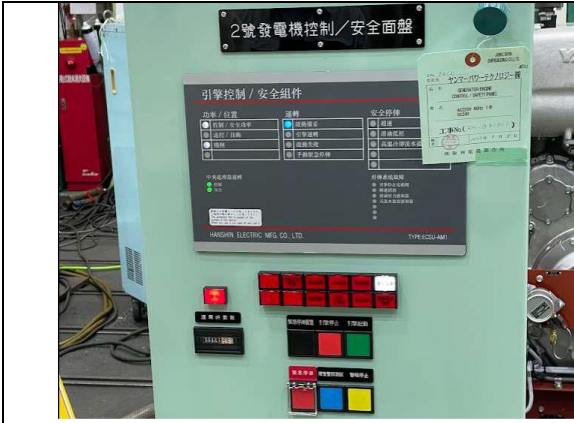
圖 16.二號發電機控制盤
