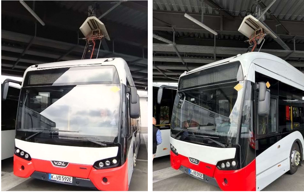
圖 60. 科隆KVB-Betriebshof Nord公車運維總站之屋頂集電弓充電設施(車頂上升型集電弓)。
