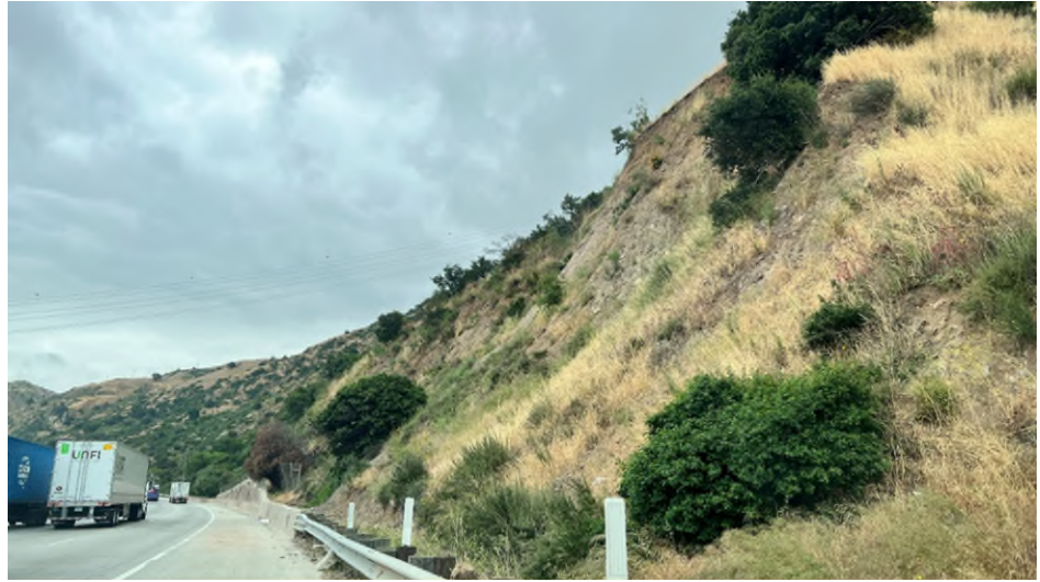
圖 45 Route 91 邊坡植生遭野火焚毀導致邊坡坍塌
