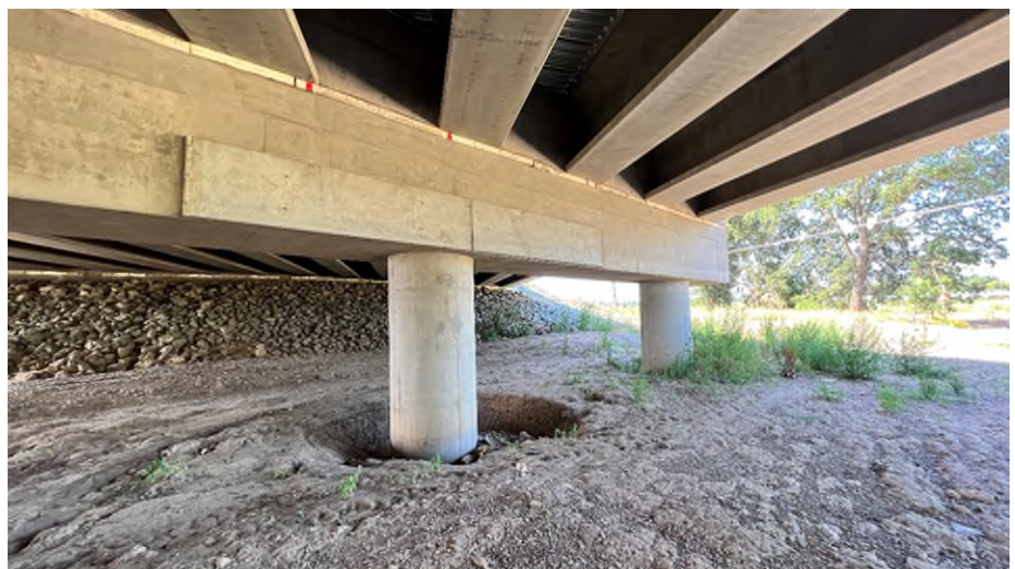
圖 51 Route 99 橋梁於 2020 年改建完成，3 年時間即發生橋墩沖刷
