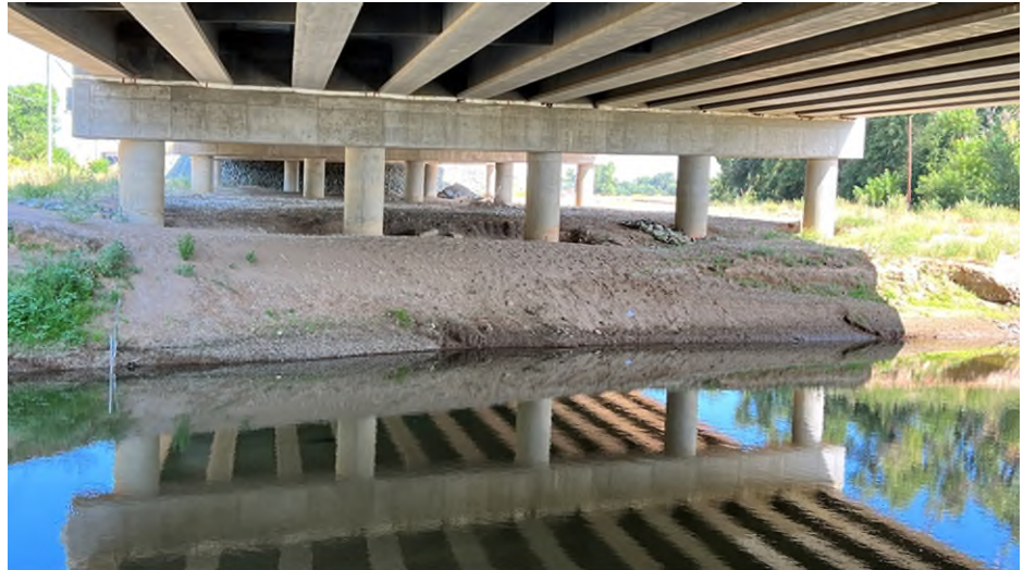
圖 52 Route 99 橋梁橋墩沖刷
