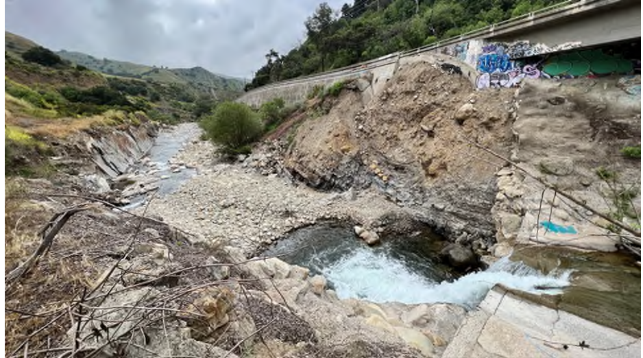
圖 34 Route 150 橋梁遭沖刷河床侵蝕、邊坡護岸遭沖毀
