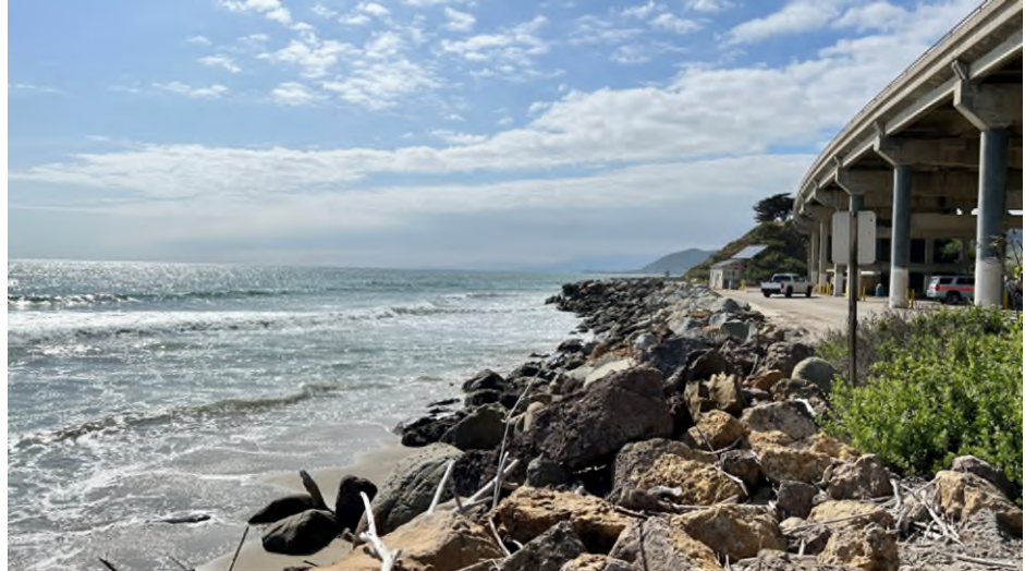
圖 40 Route 1 旁海岸侵蝕
