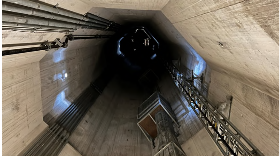
圖 57 Gerald Desmond Bridge 橋塔內設有維護電梯
