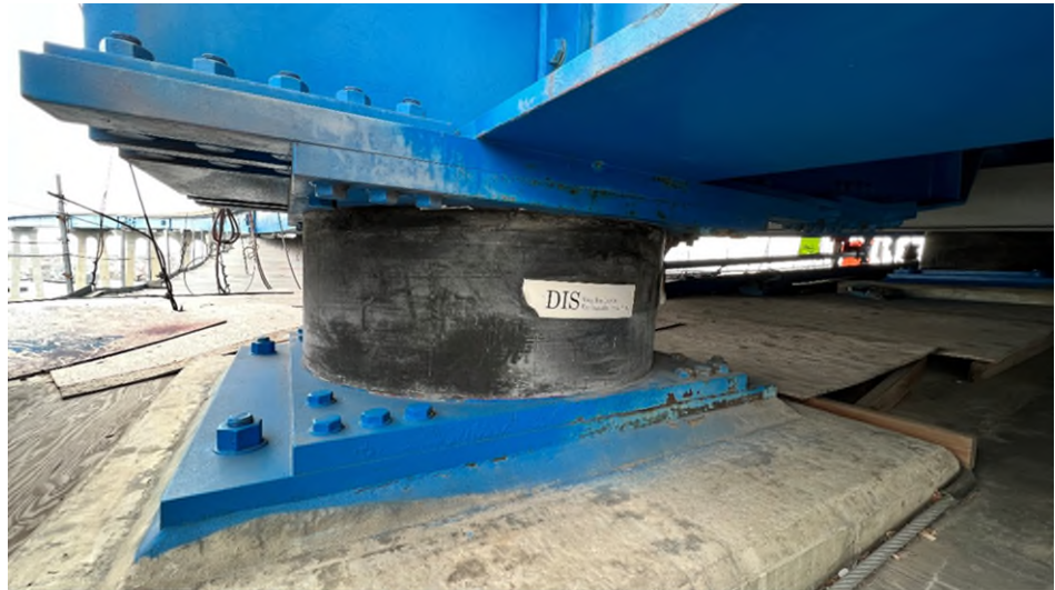
圖 60 Coronado Bridge 設置大型的 DIS 動態隔震支承
