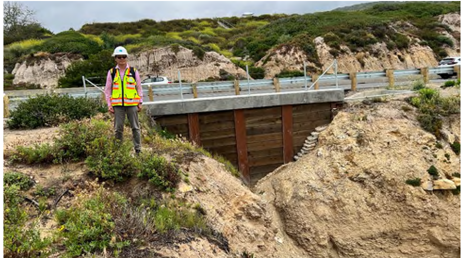
圖 42 Route 1 位於海邊，下邊坡遭沖蝕崩坍，進行保護
