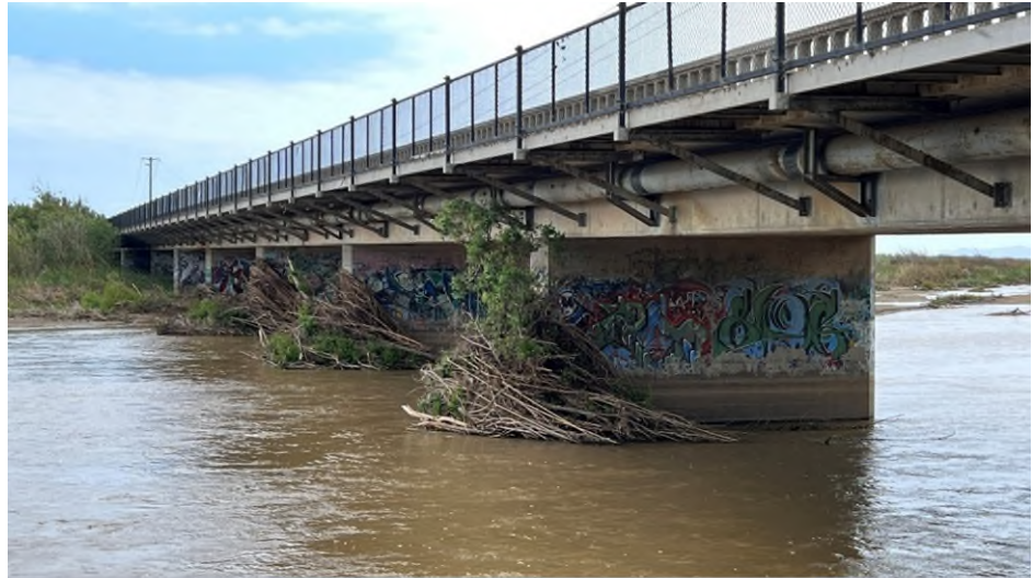
圖 37 Route 1 附近地方道路橋梁下方河道堆積洪水夾帶雜物
