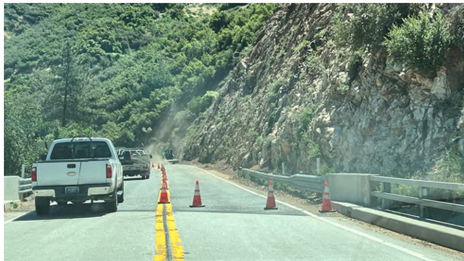
圖 28 Route 39 邊坡土石崩落
