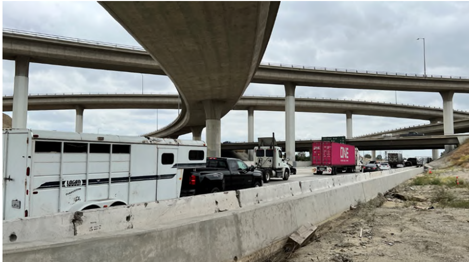
圖 67 I-5 與 I-10 交會之系統交流道橋樑檢測作業，位於車流量極為繁忙的路段執行業務十分危險，需高度集中精神
