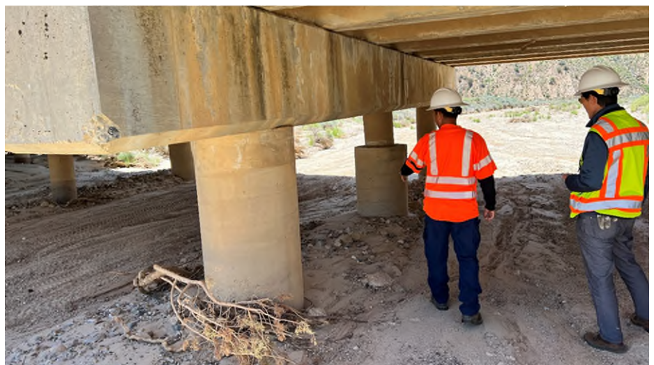
圖 36 Route 150 橋梁墩柱遭沖刷及撞擊，河床面下降
