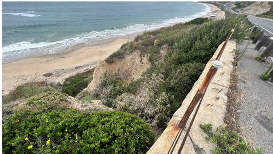
圖 43 Route 1 位於海邊之下邊坡遭海浪侵蝕
