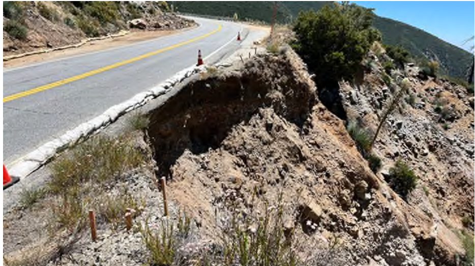
圖 29 Route 39 道路下邊坡遭冲刷淘空
