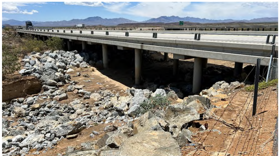
圖 46 I-40 位於沙漠中的橋梁受洪水侵襲損壞
