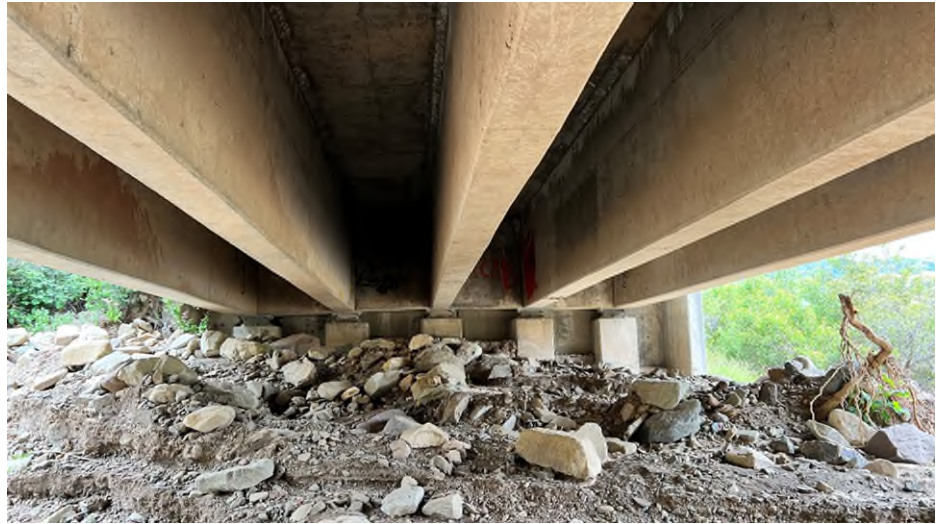
圖 35 Route 150 橋梁下方河道堆積土石，通水斷面減少，橋墩及橋台有被衝撞之虞
