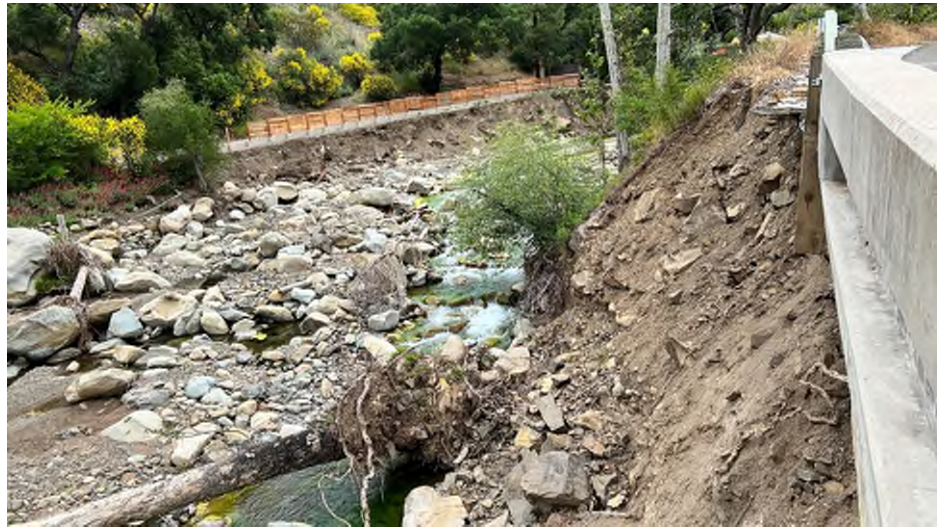
圖 38 Route 33 橋梁橋台邊坡遭冲刷裸露
