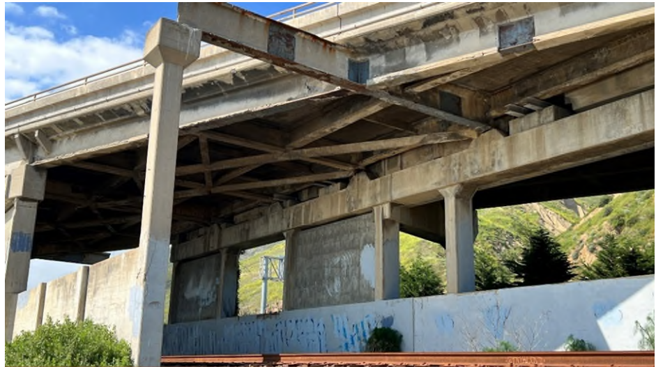
圖 41 Route 1 位於海邊橋梁，鋼構鏽蝕嚴重需要改建
