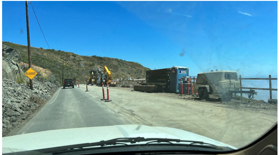
圖 50 Route 1 邊坡修復整治工程施作中，需交維封閉車道，現場僅餘 1 車道，交維人員指揮輪流放行
