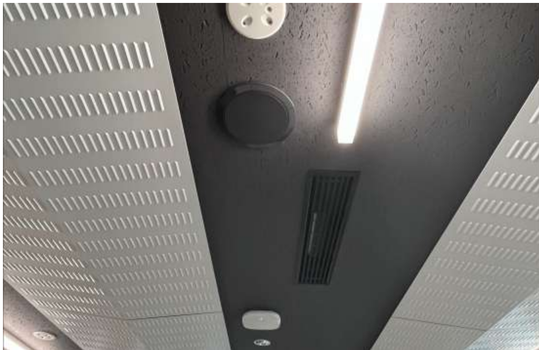
圖 70 T-Green Radiant Duct 實裝（來源：本計畫拍攝）
