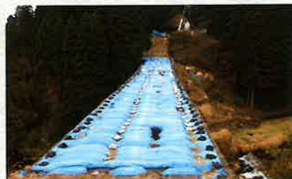
地震後の応急処置(橋上にブルーシート)
