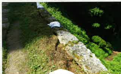
橋上端にある石材(通称:手摺石)が外側へせり出した状況
