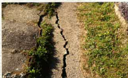
橋上の被覆土に生じた亀裂
