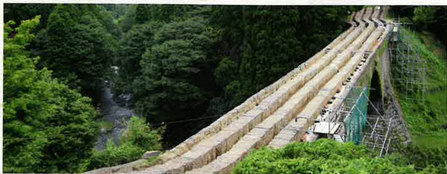
露出した通水管
