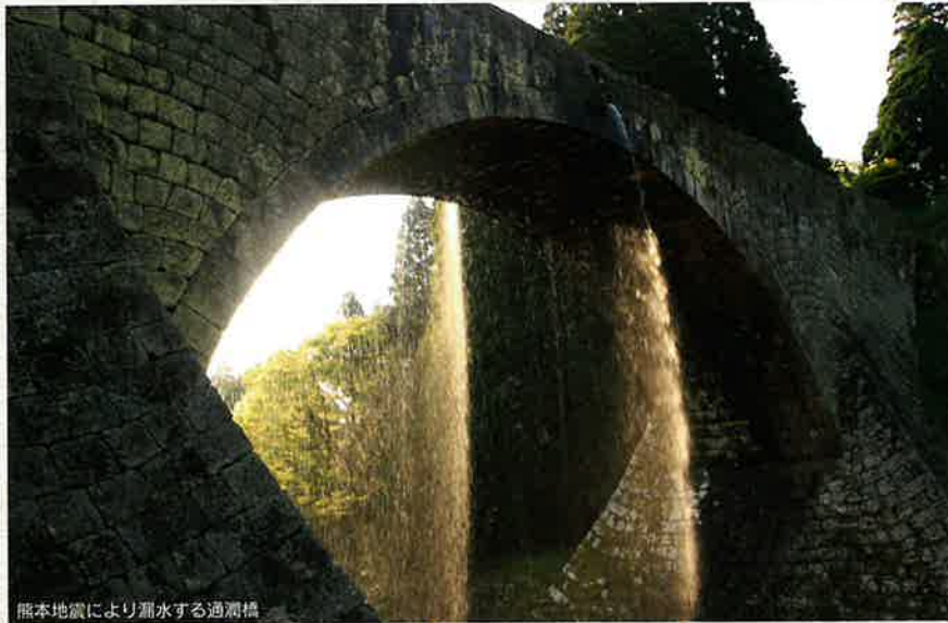
熊本地震により漏水する通潤橋
