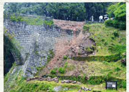
壁石垣の崩落状況
