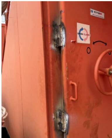
通往泵艙和倉庫的水密門因房海盜的關係都完全焊死進不去，已要求 EOS 處理。
