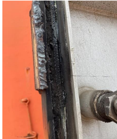
往控制室的門有解焊開來，但裡面的橡皮墊片已燒損，也要求業者改進。
