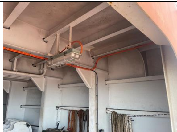
電線剪斷部分復原情形
