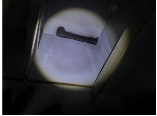
水艙頂部有燒焊痕跡
