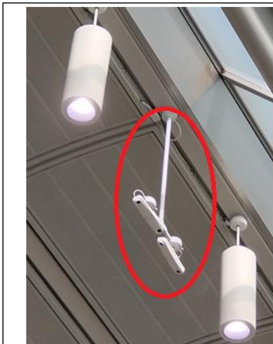
圖 28 皮爾遜機場安裝在天花板的 3D 人流感測計數器
