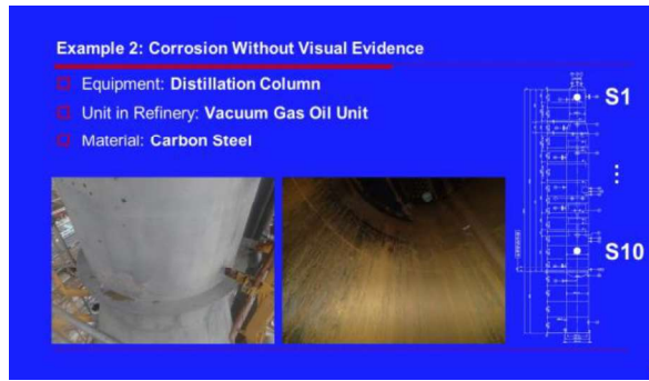
圖十三、目視檢查難以確認之腐蝕減薄_1
