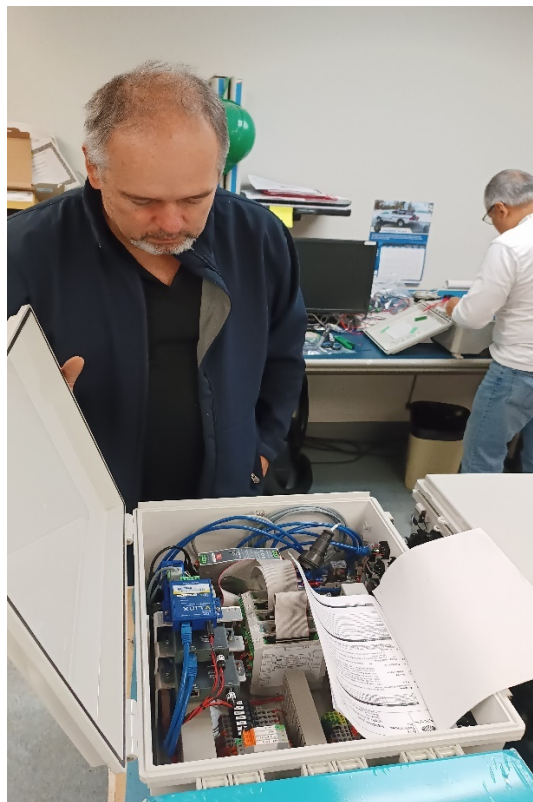
圖3.8 感測器及遙測控制箱之操作
