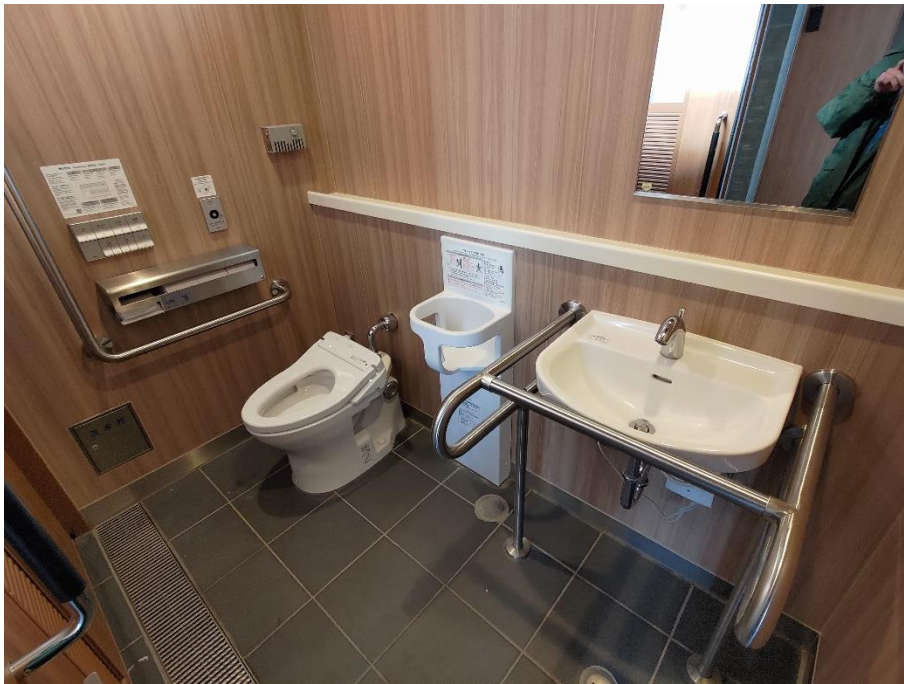
圖 4.4.9 景區公園廁所設施較為新穎
