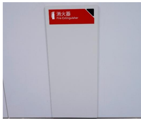
圖 4.3.47 滅火器標誌簡單卻顯眼
