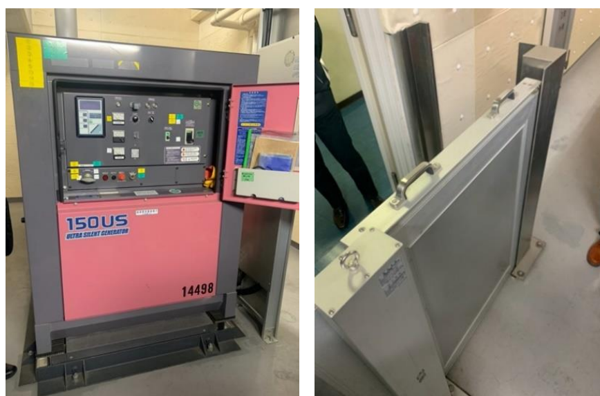
圖 8 NTT TC 之緊急發電設備及此發電室之防水隔板
