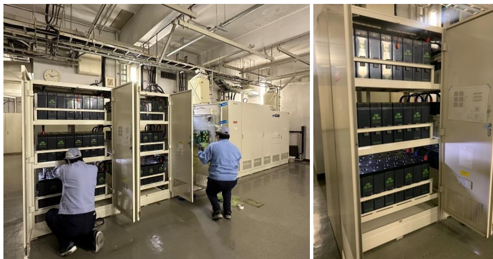
圖 7 NTT TC 之儲能設備
