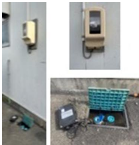
圖 23 智慧水表安裝情形
