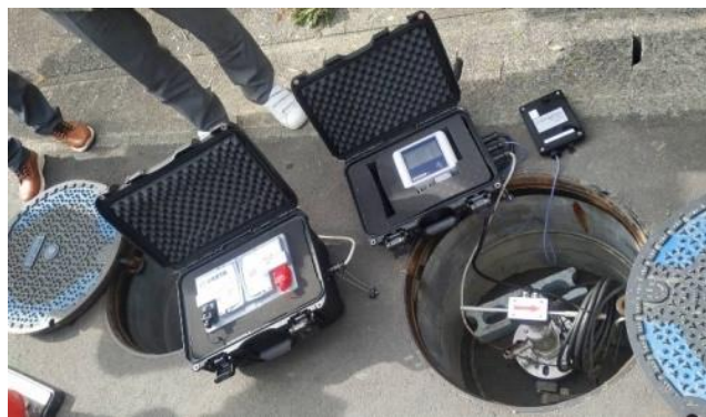
圖 22 配水樞紐點裝設之感測器
