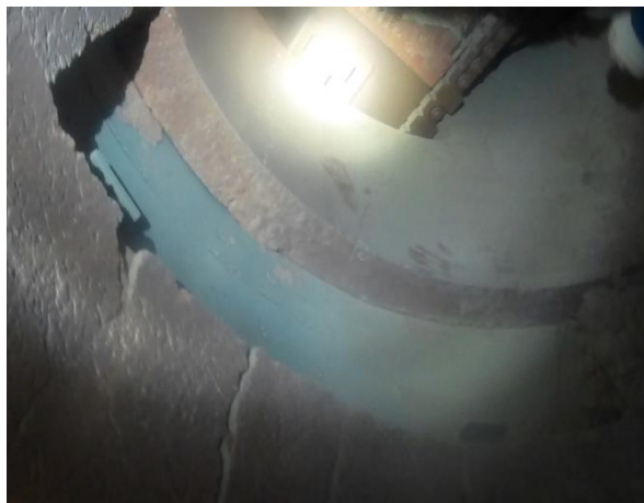
圖7 PV-1015 與下游煙道氣管線的焊道處有大面積耐火材料損壞
