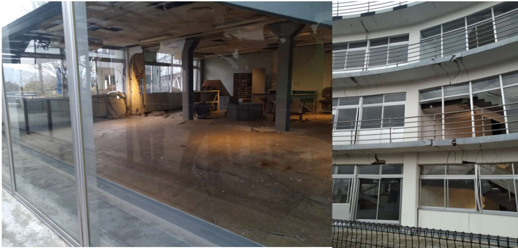
圖36 地震對教室造成嚴重損害
