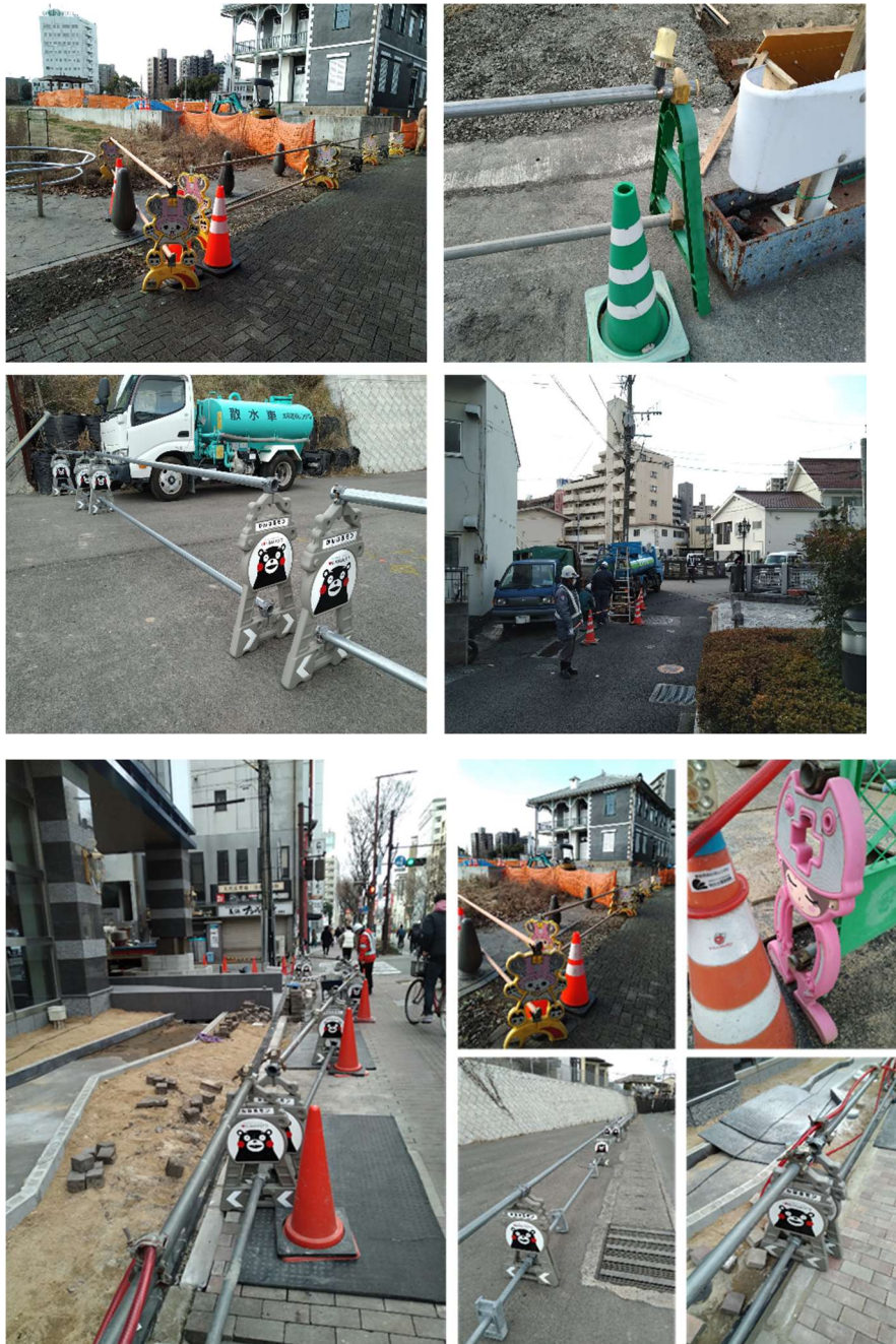
圖75 工區版式圍籬與交通錐連桿
