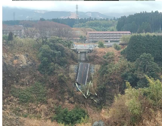
圖42 土石崩塌致阿蘇大橋損壞
