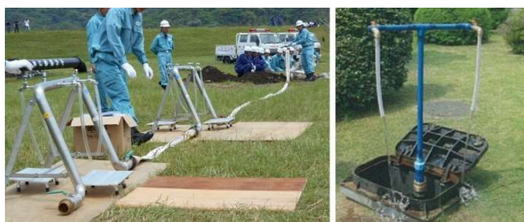
圖84 熊本市上下水道局使用消防栓作為臨時供水站情形
