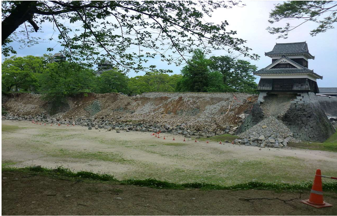
圖25 熊本城戌亥櫓左側的石垣於 2016 年熊本地震後倒塌情形
