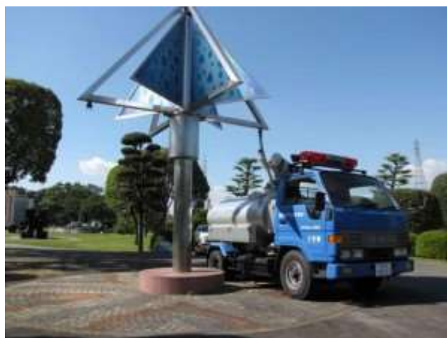
圖86 健軍水源地緊急供水車供水的設施
