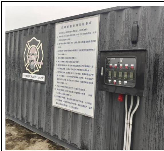
圖 3-6 訓練中心燃燒櫃熱電偶感知器
