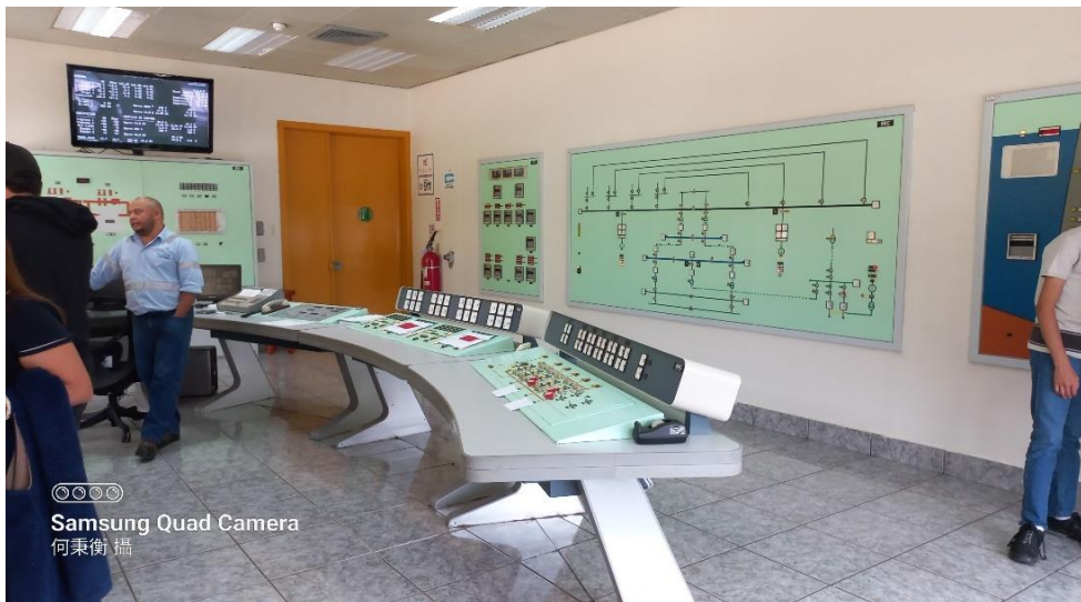
圖 84 El Cajón (CJN)電廠控制室
