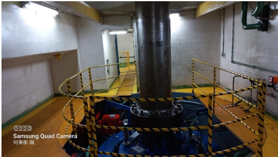
圖 81 El Cajón (CJN)發電機室下方之發電機轉軸
