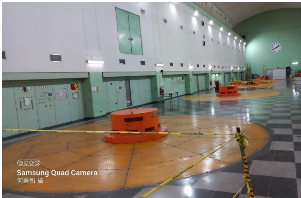
圖 80 El Cajón (CJN)發電機室之 4 部法蘭西式發電機
