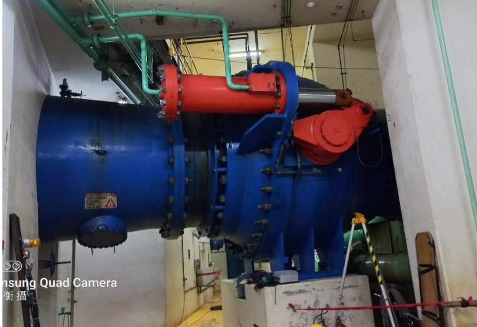
圖 79 El Cajón (CJN)之水輪機控制閥 (水由右側進入，左側為水輪機之水路入口)
