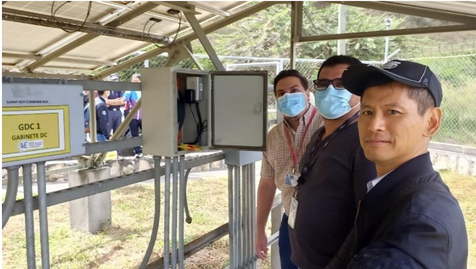
圖 72 宏電工程師帶領台電工程師說明 La Cañada PV 太陽能板出力情況
