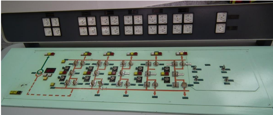
圖 87 El Cajón (CJN)電廠開關場控制盤面
