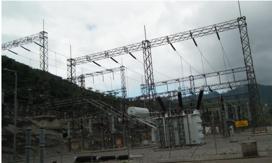
圖 83 El Cajón (CJN)發電廠開關場
