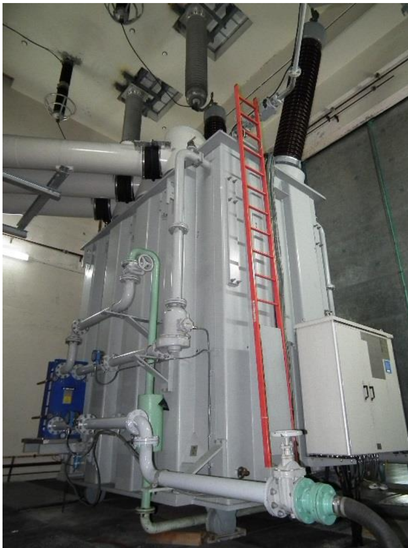
圖 82 El Cajón (CJN)發電廠發電機升壓變壓器
