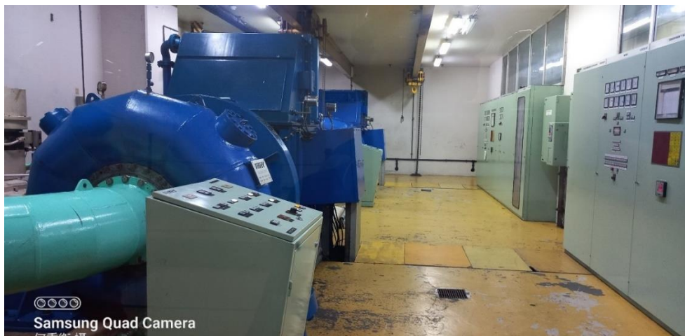
圖 86 廠內用電輔助發電機
