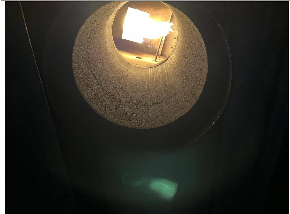
圖 3.3.5 靜岡縣消防學校燃燒櫃設施內部抽風系統。
