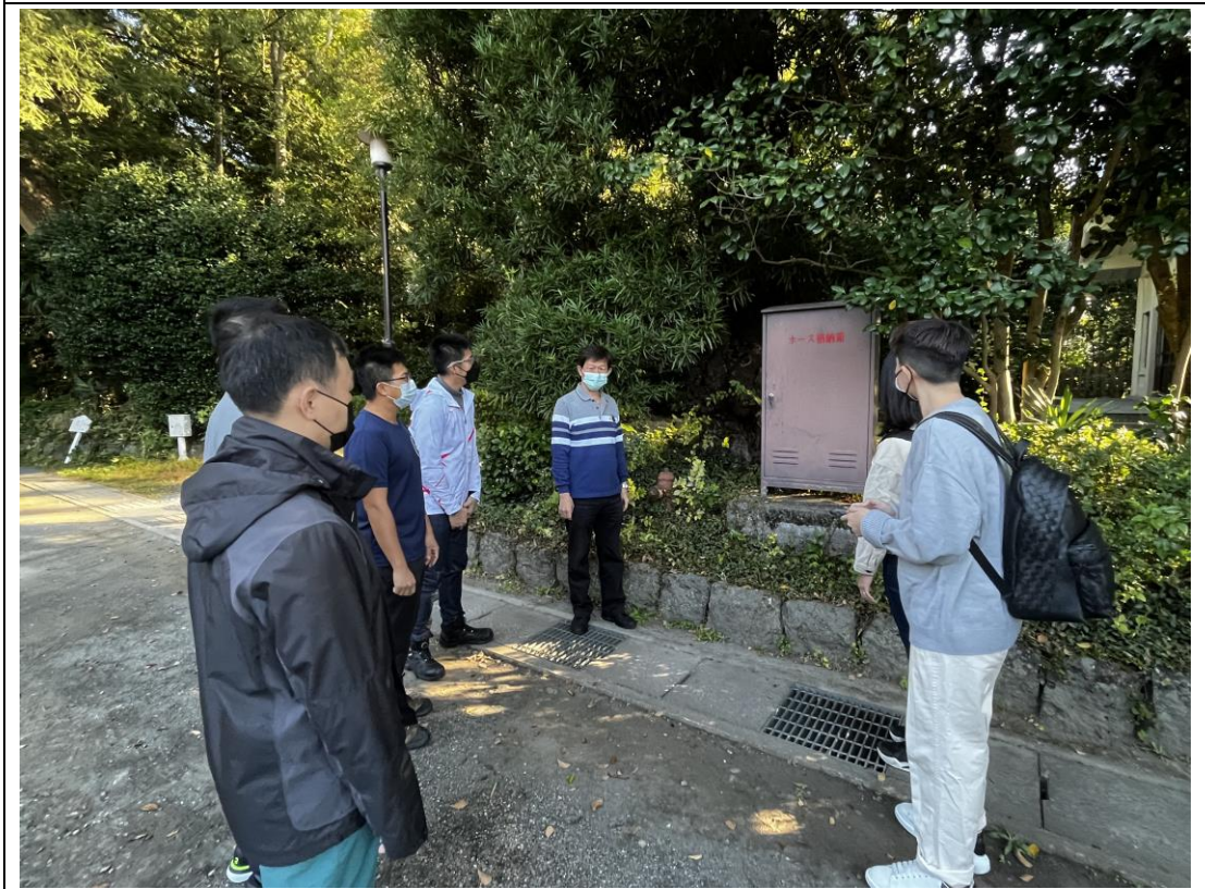
圖 3.11.2 三嶋大社外室外消防栓。
