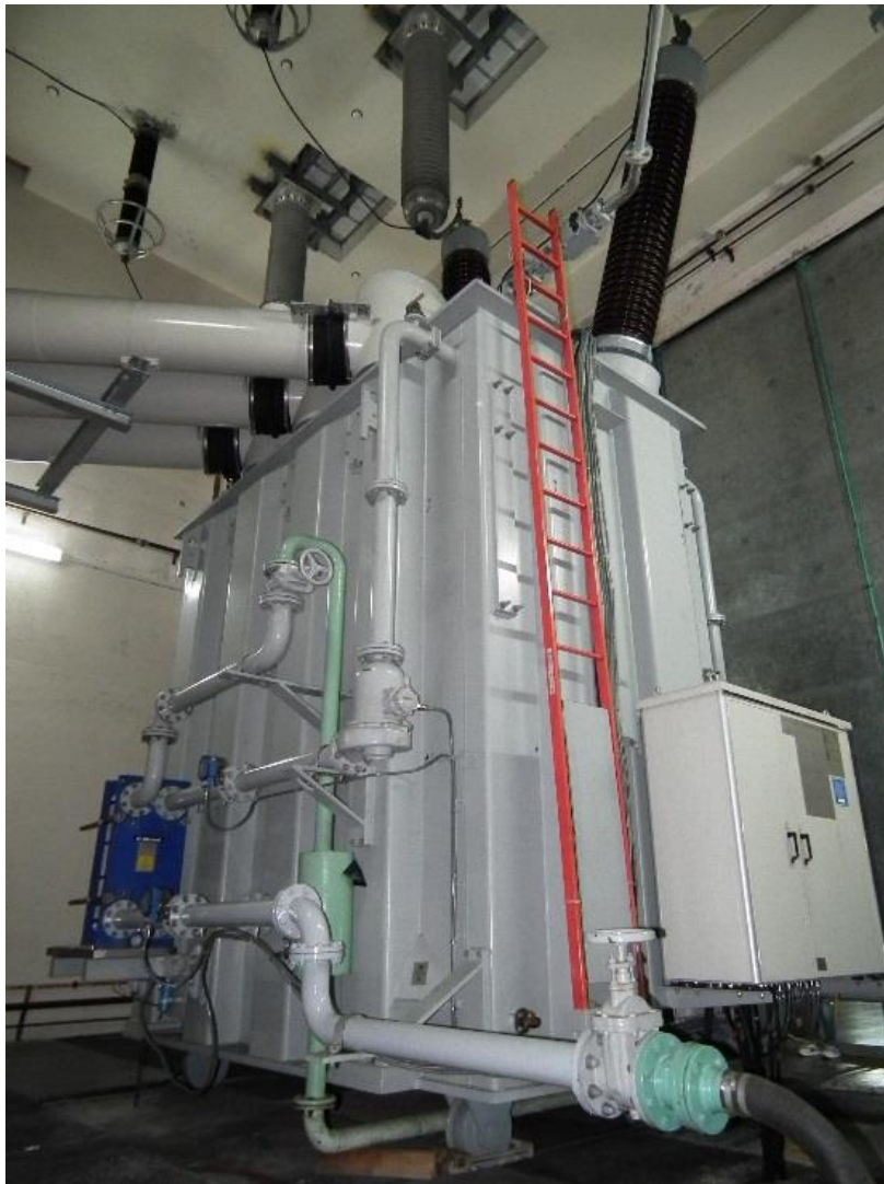
圖 110 El Cajón (CJN)發電廠發電機升壓變壓器
