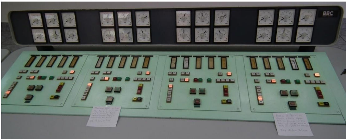
圖 116 El Cajón (CJN)電廠發電機運轉控制及資訊盤面
