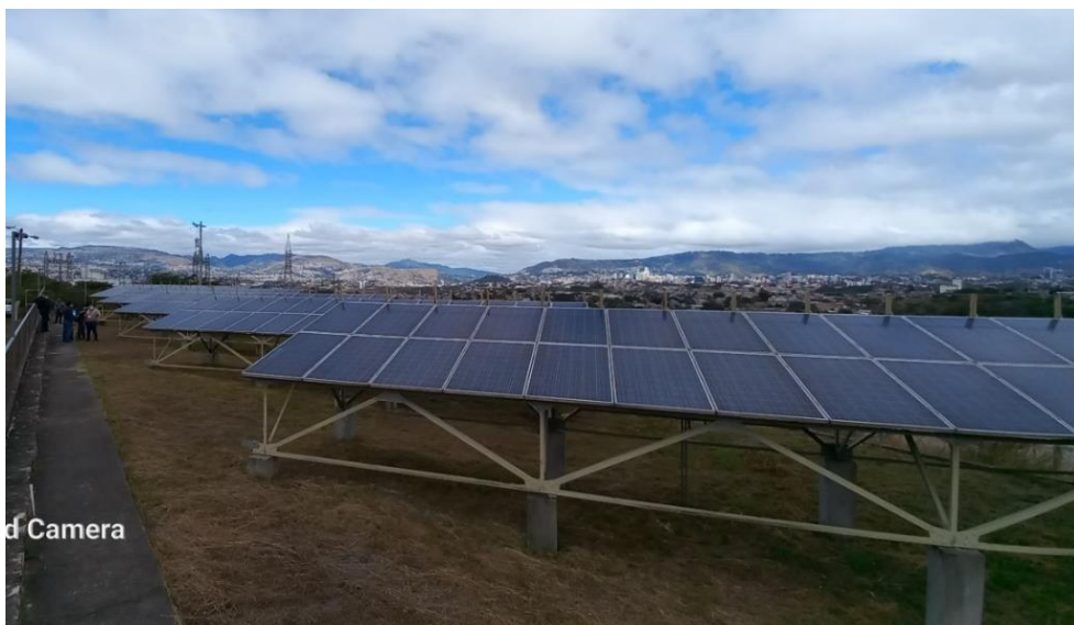
圖 96 La Cañada PV 太陽能板
