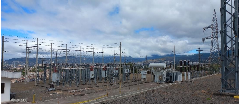
圖 92 線路經避雷器後經一台配電變壓器降壓為 13.8kV 送配電開關場
