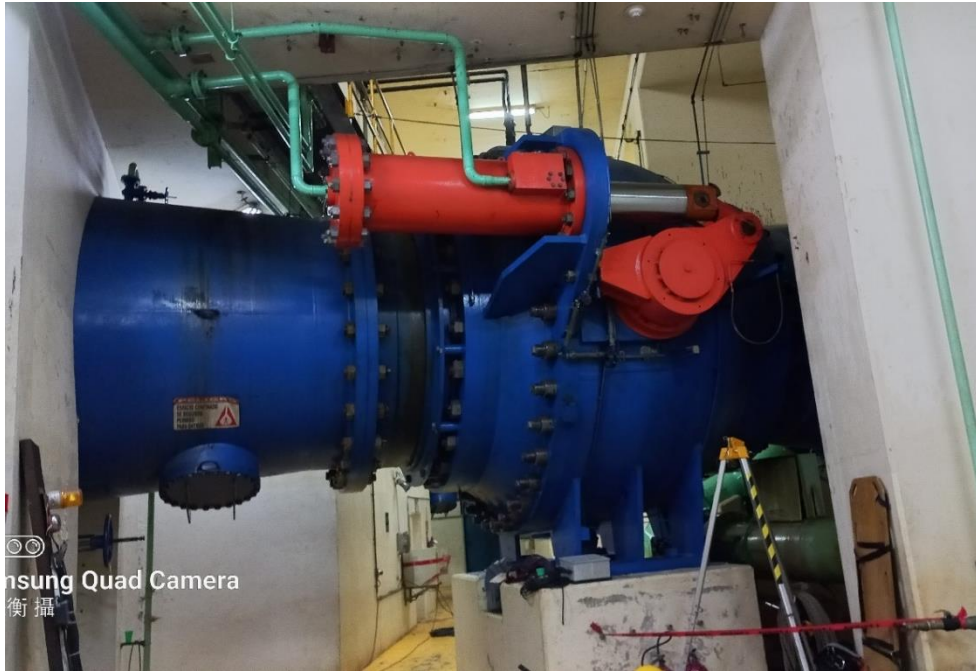
圖 107 El Cajón (CJN)之水輪機控制閥 (水由右側進入，左側為水輪機之水路入口)
