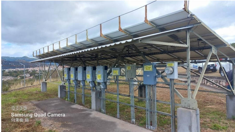
圖 97 La Cañada PV 太陽能板之變流器
