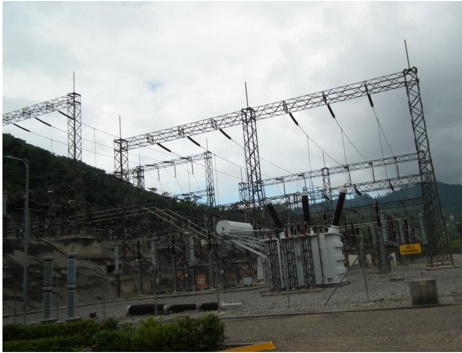
圖 111 El Cajón (CJN)發電廠開關場
