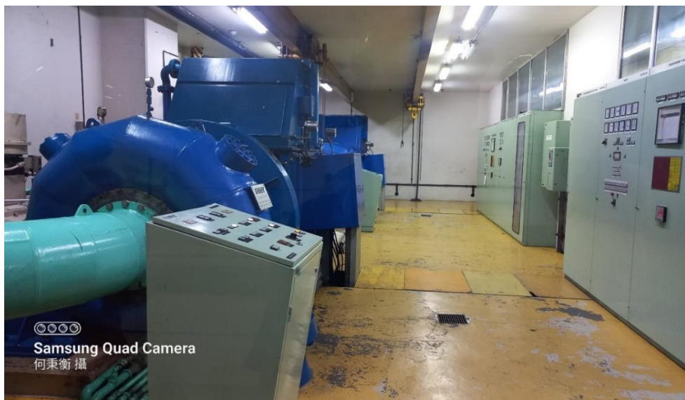
圖 114 廠內用電輔助發電機
