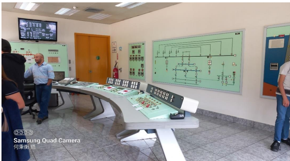
圖 112 El Cajón (CJN)電廠控制室
