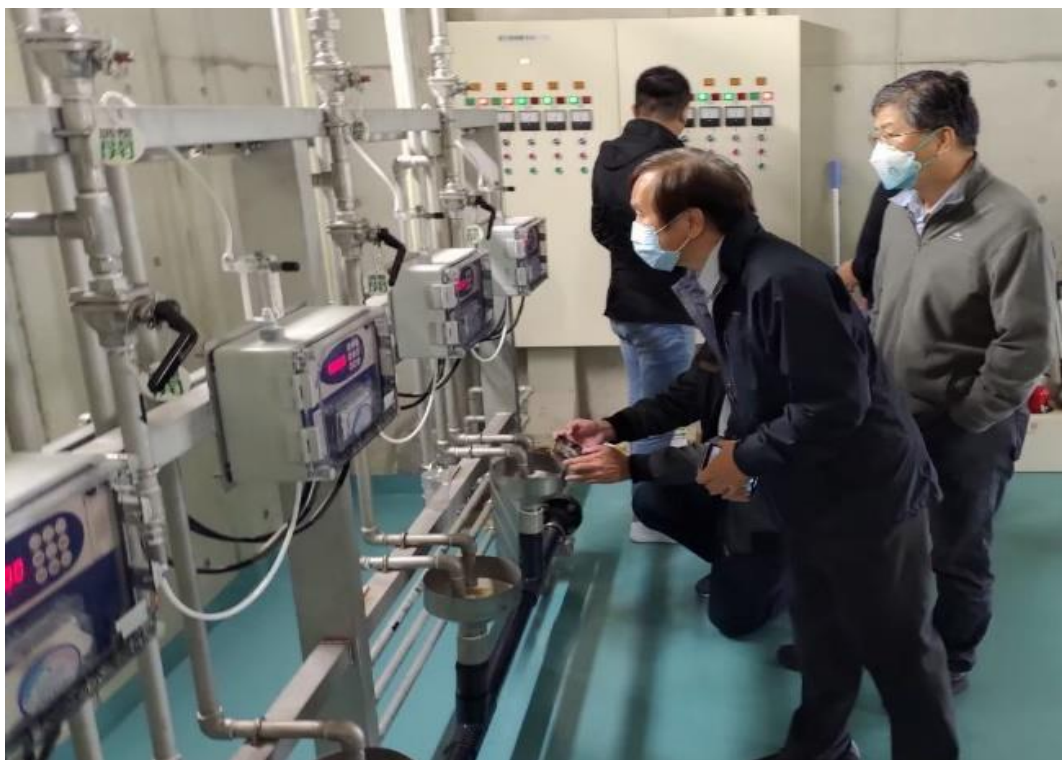
圖 2-淨水廠內產水水質即時監控系統
