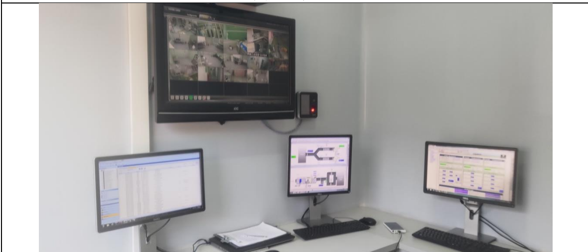
NSB3A 實驗室中控室，可即時監控人員進出及進排氣系統之運作狀況。
