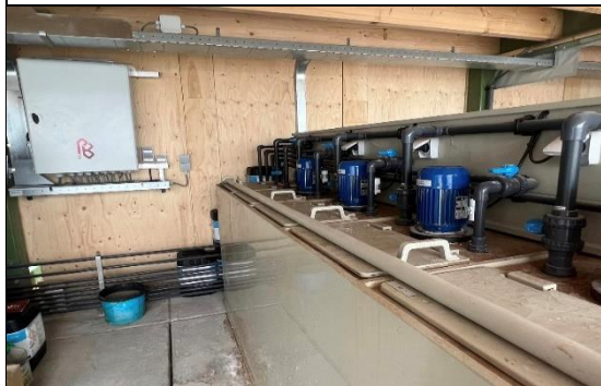
圖 59.養液配置設備
