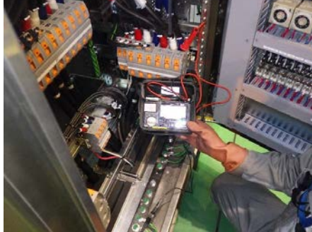
圖 56_絕緣電阻量測確認
