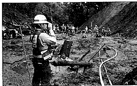
土砂崩れ現場調査 【神奈川県相模原市】 （九州地方整備局）
