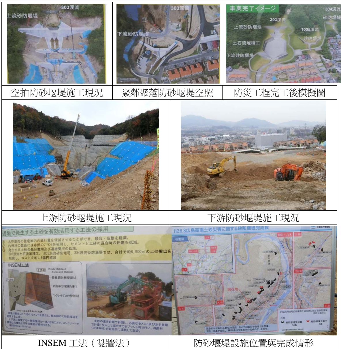
圖 25 廣島市八木地區土石流災害復建工程執行現況及施工情形
