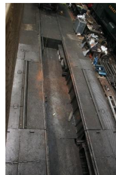
圖 70、泰斯利機車廠內的車輪維修的升降設備，透過使用該設備，機關車可不需透過天車吊掛拆卸車輪
