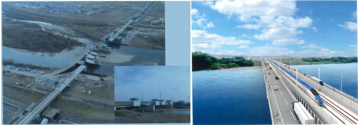
九頭竜川橋梁(鐵道・道路一體橋) 施工照片及完工示意圖
