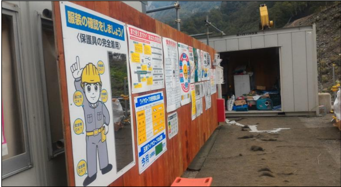
圖 45 職業安全衛生設備-職安宣導走廊照片
