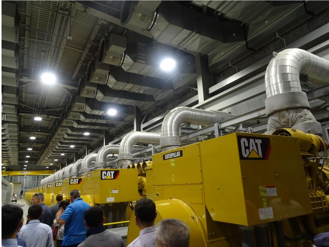
照片 2-10 第 17 街運河抽水站發電機組
