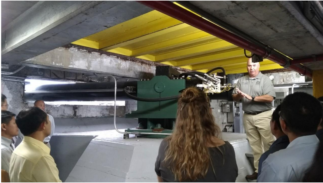
照片 2-2 控制閘門起閉的設備
