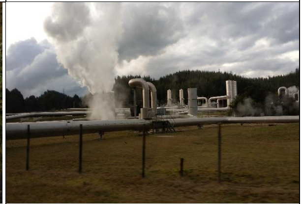
圖 20：懷瑞基地熱發電站
